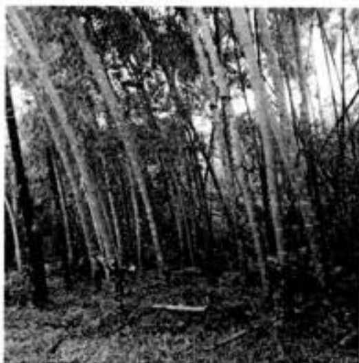
Fotografía No. 3. Observación de la estructura y estado de los culmos de guadua.
