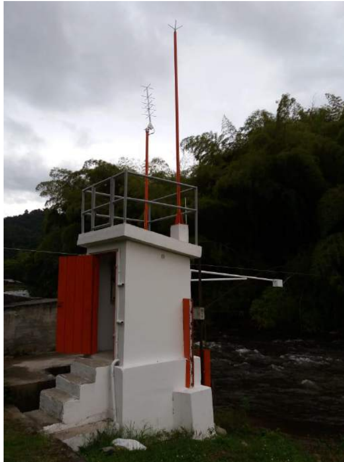
Fotografía 1. Estación Hidrométrica Automática de Nivel Bocatoma EPA
