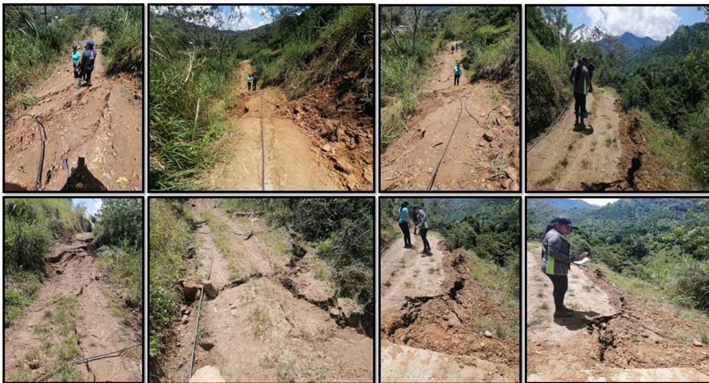
VISITA TECNICA EN LOS PREDIOS EL PORVENIR SECTOR LOS BALSOS, EN EL MUNICIPIO DE PIJAO, EVALUACIÓN DE PROCESOS EROSIVOS ACTIVOS EN LA ZONA
