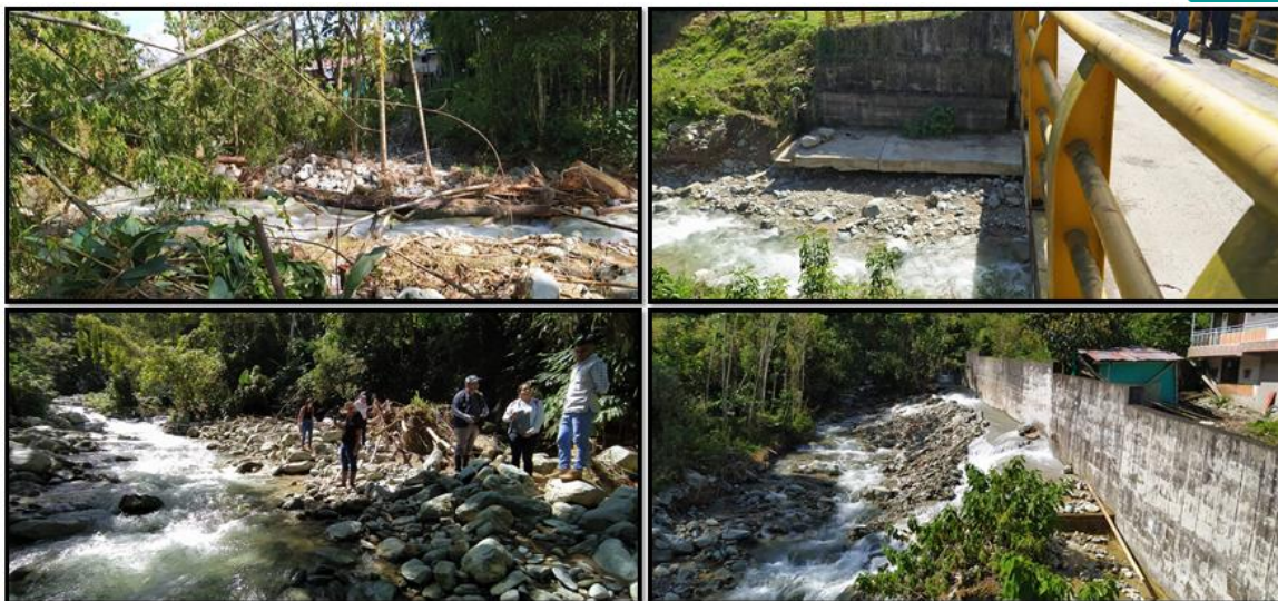
VISITA TECNICA EN LA QUEBRADA LA ESPAÑOLA, MUNICIPIO DE CORDOBA, EVALUACION DE AFECTACIONES POR TEMPORADA DE MAS LLUVIAS.
