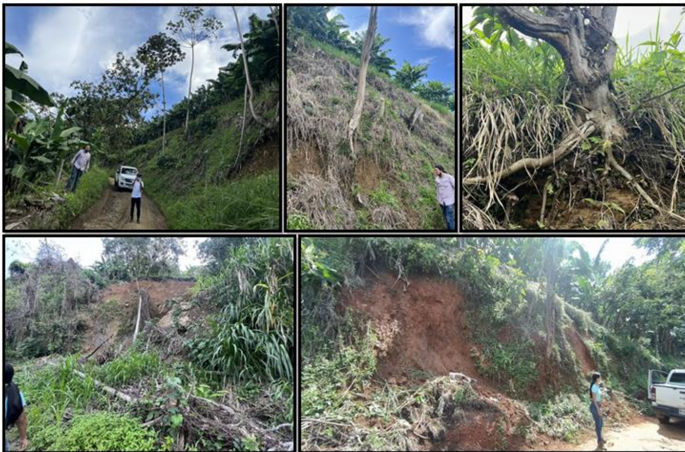
VISITA TECNICA EN EL PREDIO LA FLORIDA, VEREDA CAÑAVERAL, MUNICIPIO DE PIJAO, EVALUACION DE AFECTACIONES EN TALUD Y ZONAS AÑEDAÑAS.
