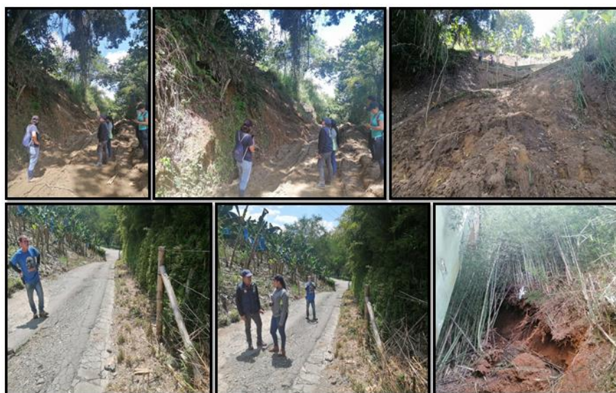
VISITA TECNICA EN EL PREDIO ALTA FLOR Y COLEGIO LUIS GRANADA MEJIA, MUNICIPIO DE PIJAO, EVALUACIÓN AFECTACIONES EN TALUD
