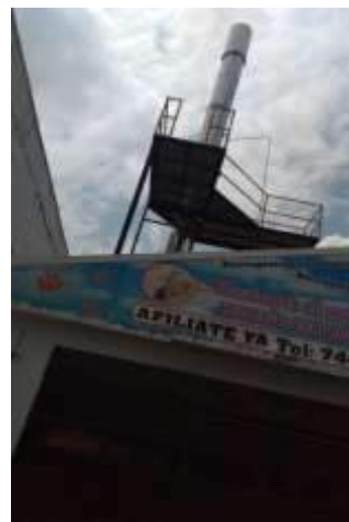
Foto 2. Chimenea con plataforma de muestreo
