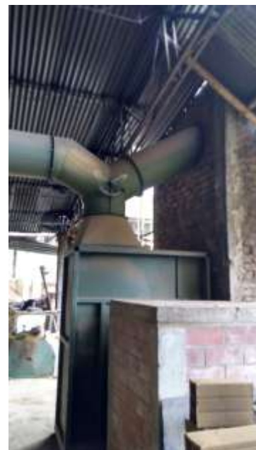
Foto 2. Sistema de ductos que conducen gases de hornos hacia cámaras de secado y chimenea
