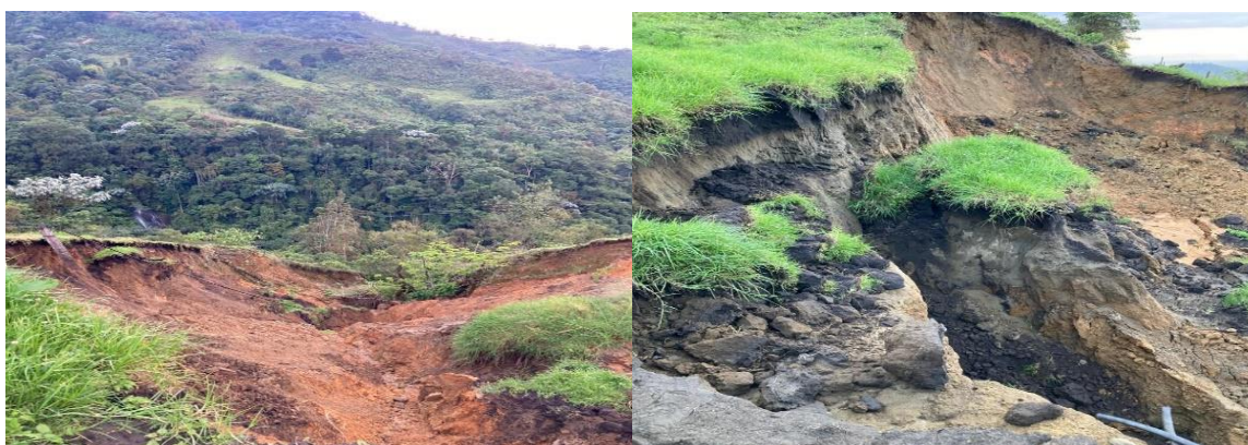
Visita técnica, municipio de Córdoba, vereda media cara afectación deslizamiento sobre el rio verde, 9 de marzo de 2021
