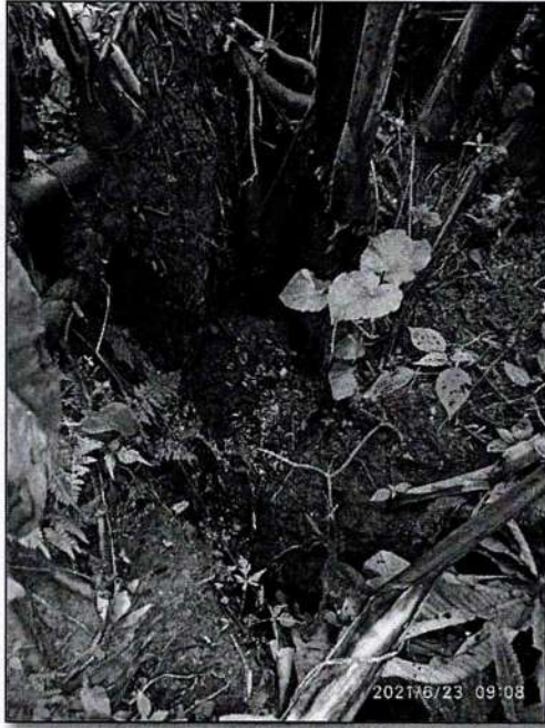
Figura 4. Sector con afloramiento de agua
