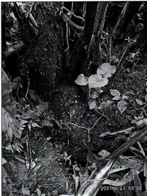
Figura 4. Sector con afloramiento de agua
