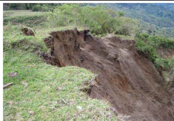
Deslizamiento en masa, formando cárcava predio El Placer. Registro fotográfico 2011
