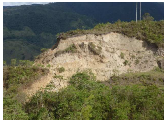
Deslizamiento en masa aparente estado estable, predio El Placer. Registro fotográfico 2013
