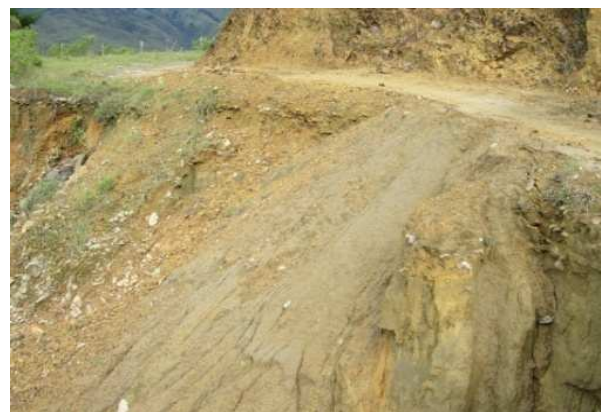
Perdida de la vía, predio El Placer. Registro fotográfico 2011
