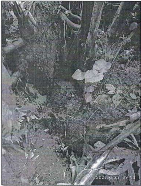
Figura 4. Sector con afloramiento de agua
