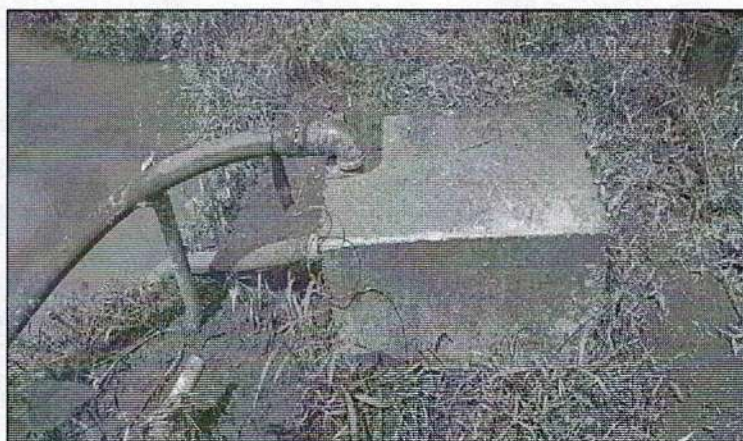
Imagen 3. Bomba instalada Triturado Tesorito – tomado de visita técnica de 09 de febrero de 2021
