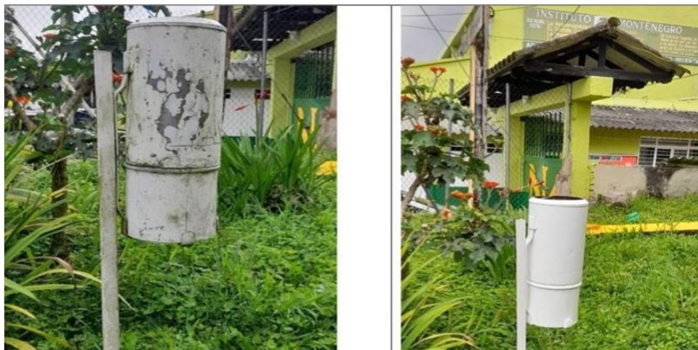
Antes y después del mantenimiento al pluviómetro de la estación Instituto Montenegro
