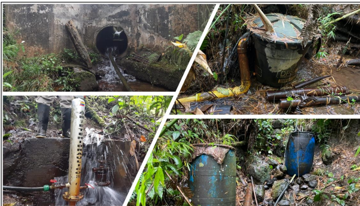
Figura 26. Captaciones nuevas en el municipio de Filandia, Quindío.
