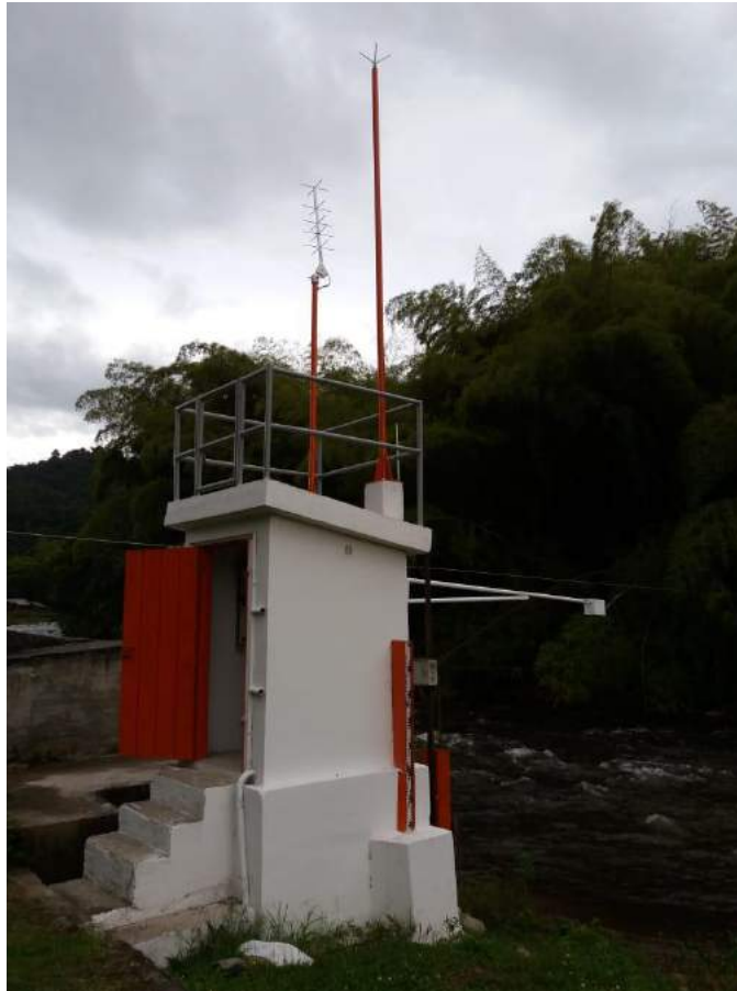
Fotografía 1. Estación Hidrométrica Automática de Nivel Bocatoma EPA
