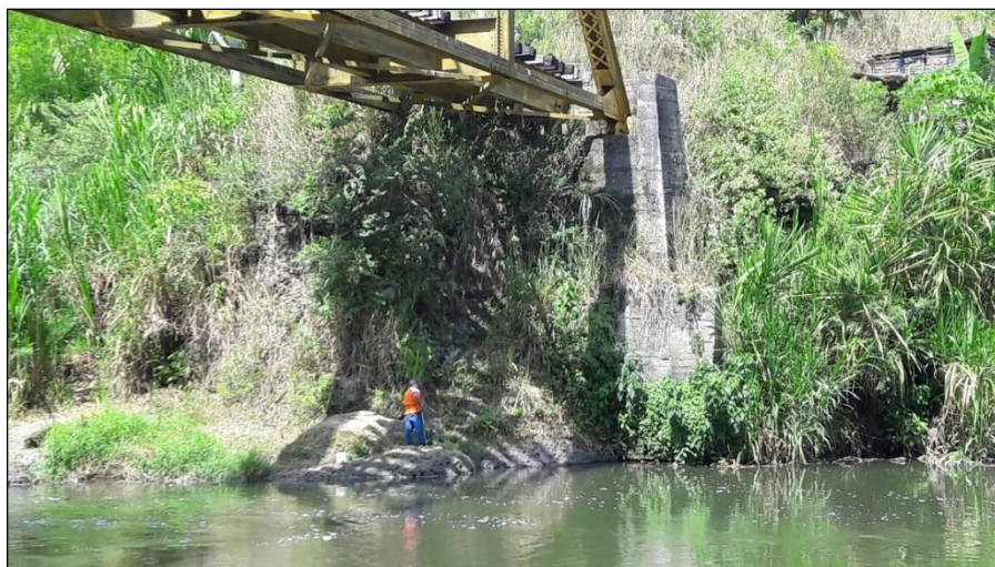
Fotografía 12 Erosión lateral presente cerca al puente ferroviario.
