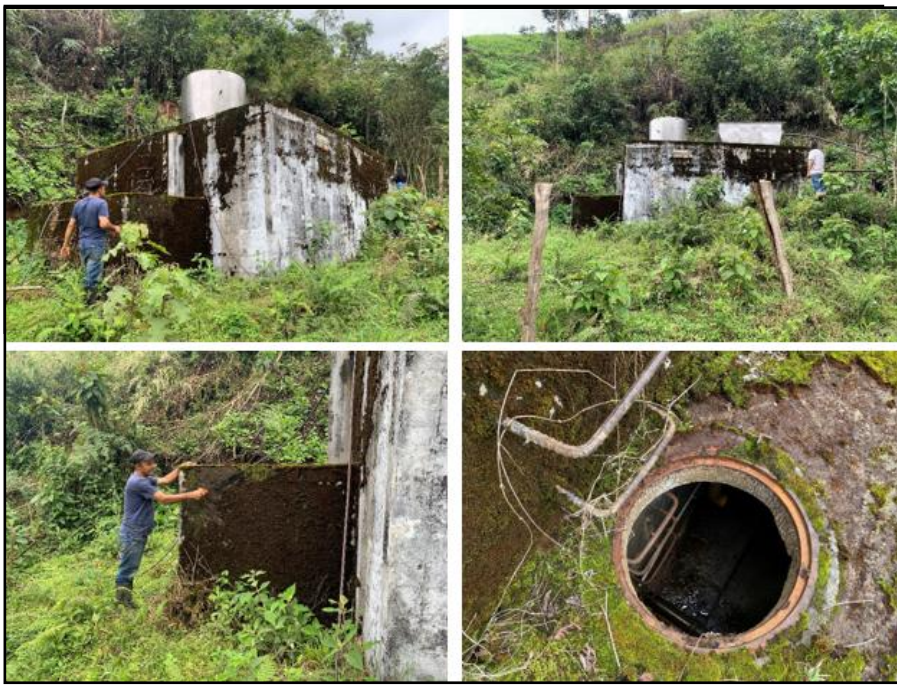
Imagen 7. Afectación punto 5 coordenadas: 4° 8' 9,00" N -75° 50' 28,79" W. Fuente: CRQ.
