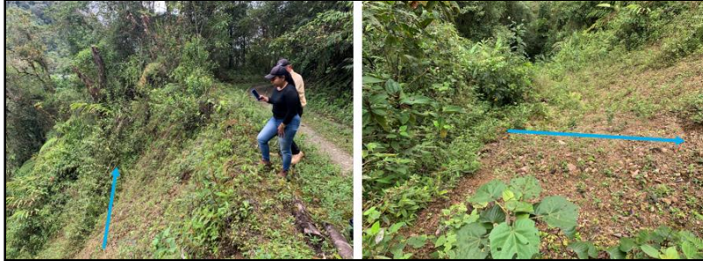
Imagen 4. Afectación punto 2 coordenadas: 4° 8' 43,51" N -75° 50' 25,79" W. Fuente: CRQ.
