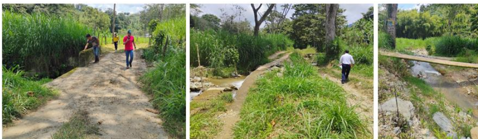
Inspección afectación Quebrada Negra, Corregimiento La Virginia. - Calarcá
