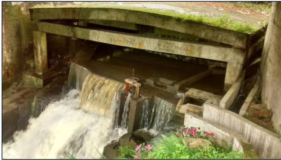
Figura 11. Bocatoma ESAQUIN SA ESP, municipio de Filandia
