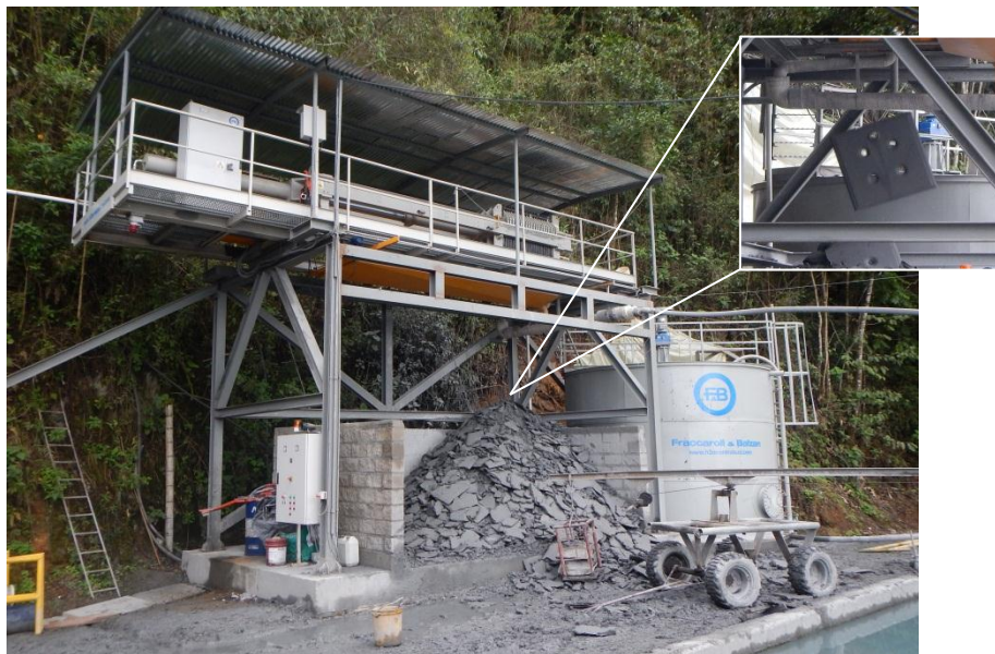
Figura 2. Compactador de lodos, túnel de la Línea
