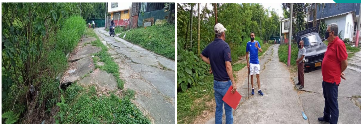
Visita barrio siete de agosto municipio de Armenia, Afectación de la vía septiembre 24 de 2020
