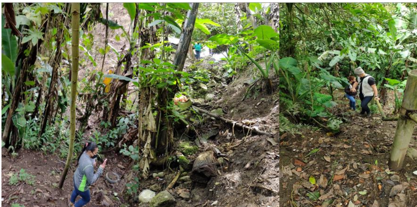
VISITA TECNICA MUNICIPIO DE CIRCASIA, BARRIO EL RINCON, DONDE SE PRESENTÓ "AFECTACIÓN POR PROCESOS EROSIVOS.
