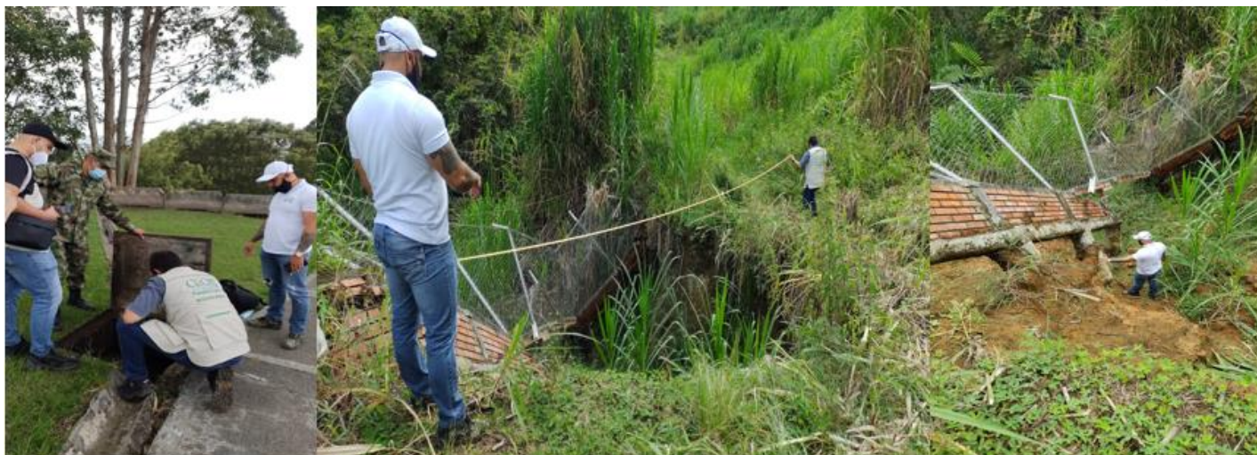
VISITA TECNICA MUNICIPIO DE ARMENIA AL BATALLÓN NO. 8 "ASPC 8 – CACIQUE CALARCÁ" UBICADO EN LA AVENIDA CENTENARIO DE ARMENIA, AFECTACION "PROBLEMAS DE DESLIZAMIENTO EN LADERA Y COLAPSO DE OBRA INGENIERIL (MAMPOSTERIA Y MALLA ESLABONADA)"
