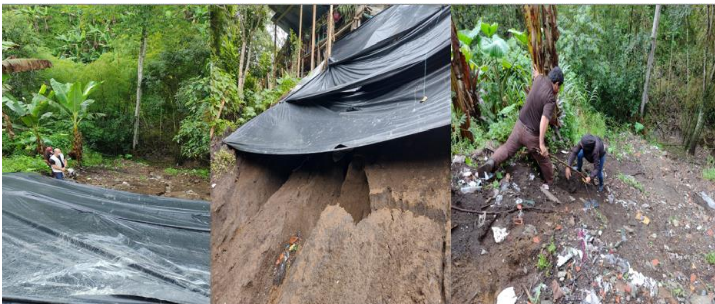
VISITA TECNICA MUNICIPIO DE QUIMBAYA EN EL CASERIO NARANJAL DONDE SE PRESENTO "AFECTACION POR MOVIMIENTOS DE REMOCIÓN EN MASA".
